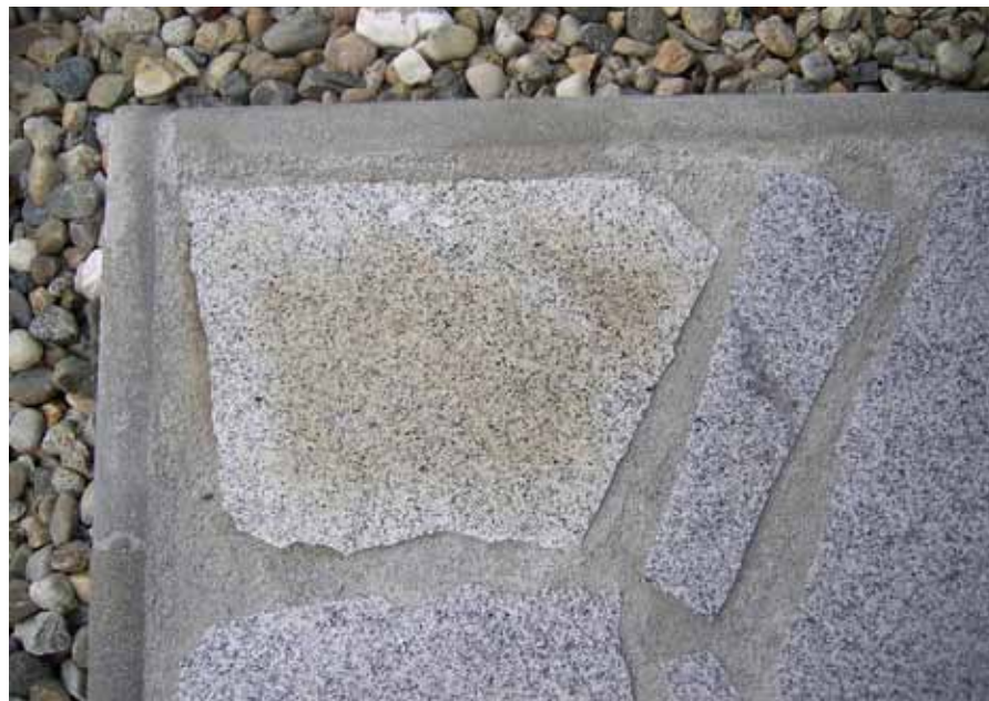
4 Gelbe Flecken bei einem chinesischen Granit auf einer Terrasse vor der Behandlung ...
