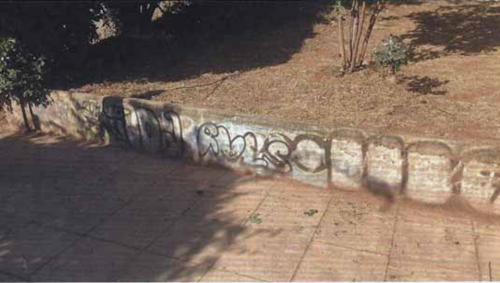
Vorher, im Frühling 2018: Schmierereien wie auf dieser Mauer finden sich überall auf Mauern, Bänken und Säulen der Anlage
