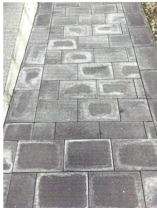
Außenanlage mit Kalkausblühungen
