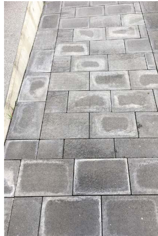
Außenanlage mit Kalkausblühungen.
