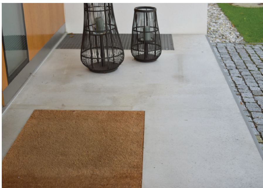
Betonfertigteile wurden mit Holzbalken als Abstandhalter während des Transportes und der Lagerung vor dem Einbau getrennt. Hier ist deutlich erkennbar, wie die Gerbsäure von den Holzbalken in die Betonfertigteile eingedrungen ist.
