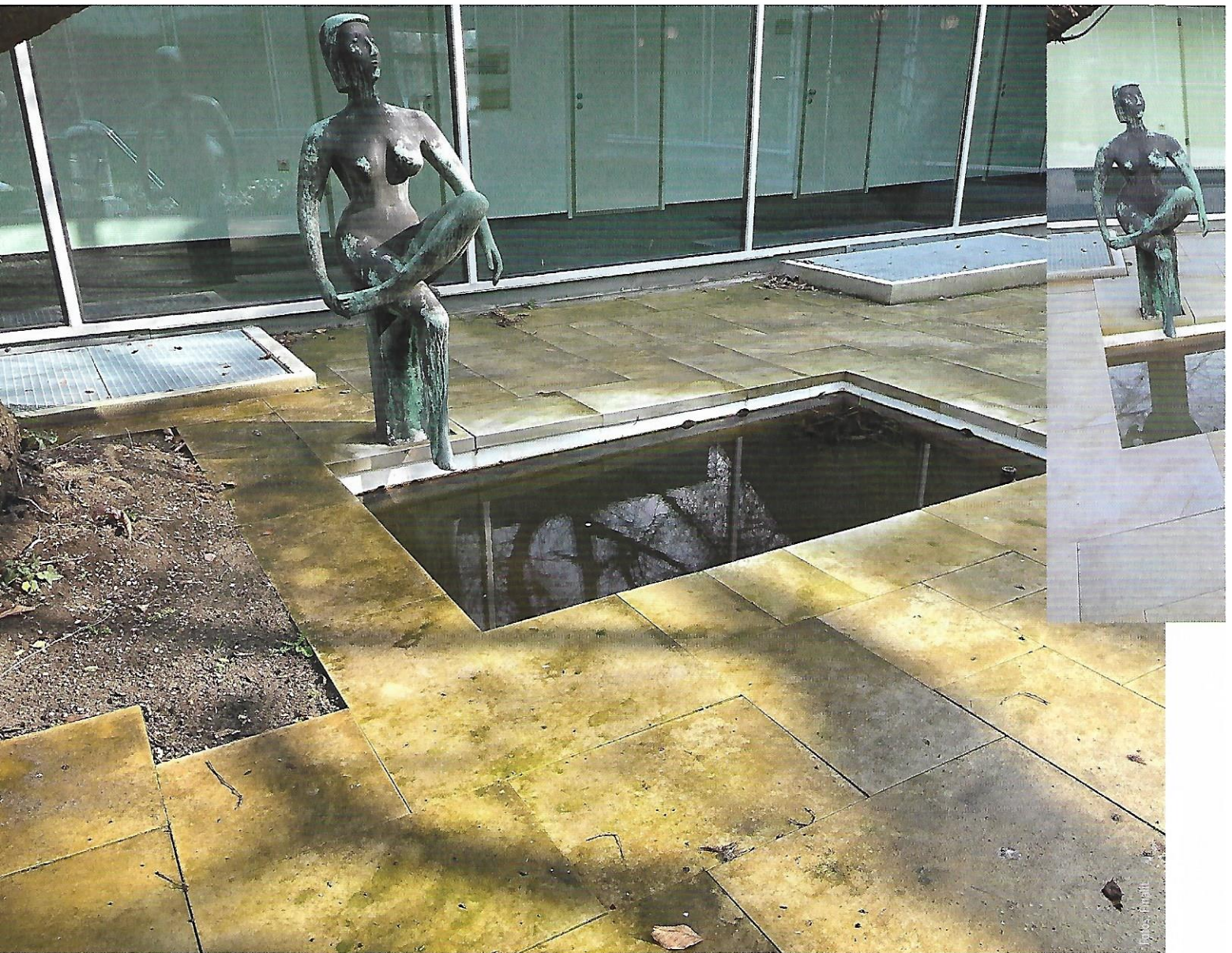
Die Vorbehandlung macht den Unterschied: Offenporiger Sandstein, der nicht vorbehandelt unter freiem Himmel verlegt wurde. Die Witterung, organische Materialien und Schmutz sind innerhalb kurzer Zeit in den Naturstein eingedrungen.
