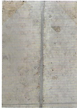
Auch wenn der Aufwand hoch ist, lassen sich Fugenrandverfärbungen wieder beseitigen.
